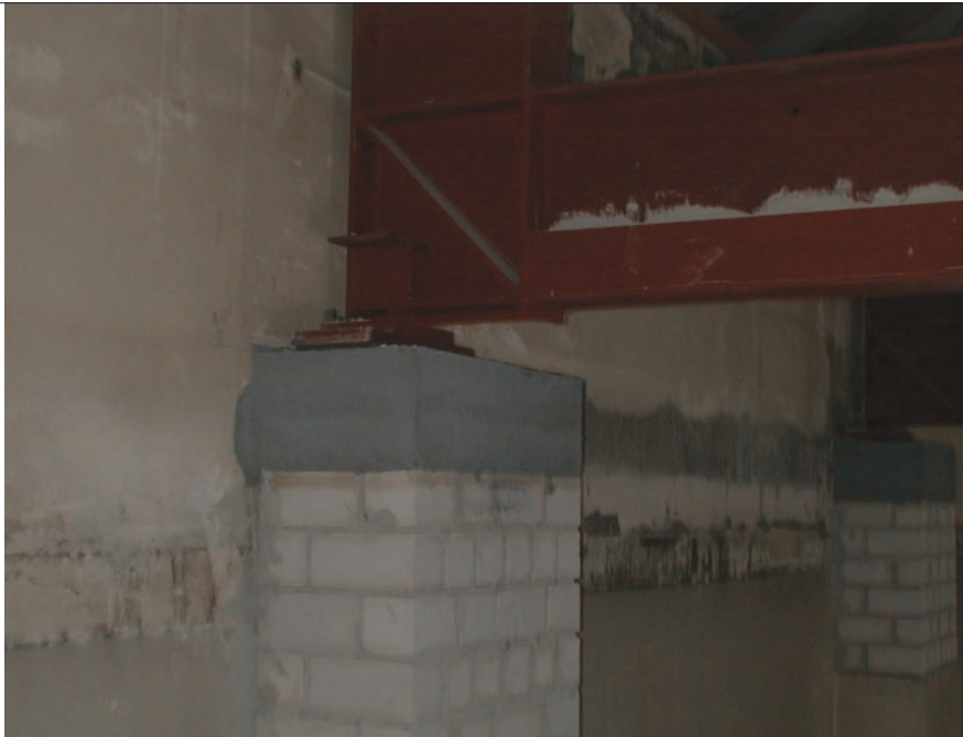
Eines der Elastomerlager, die den Studiobereich tragen
